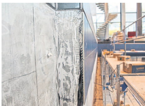
DER SIEBENSCHICHTIGE UNTERBAU IST FERTIG, die ersten Fliesen im Springerbecken sind geklebt. Die Fliesenleger arbeiten sich Stück für Stück das Becken hinunter.
