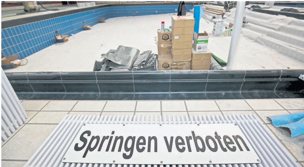
DIE ÜBERLÄUFE werden mit Plastikabdeckungen abgesichert, die entsprechend bebildert sind. Noch ist das Lehrschwimmbecken nicht mit Wasser befüllt, aber auch dieses soll Ende Februar wieder genutzt werden können. Zuvor wird es laut Therme auch eine Anmeldefrist für Schwimmkurse geben. Fotos: at
