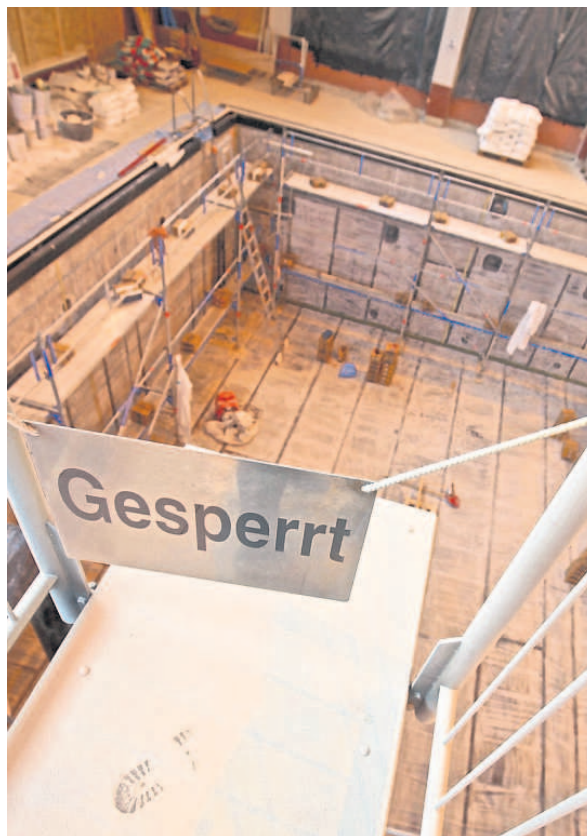
SO SOLLTE MAN LIEBER KEINEN SPRUNG WAGEN: Noch wird am Springerbecken gearbeitet. Wie alle Becken der Therme ist es nun mit dem Q7-System der Firma Steuler abgesichert.
