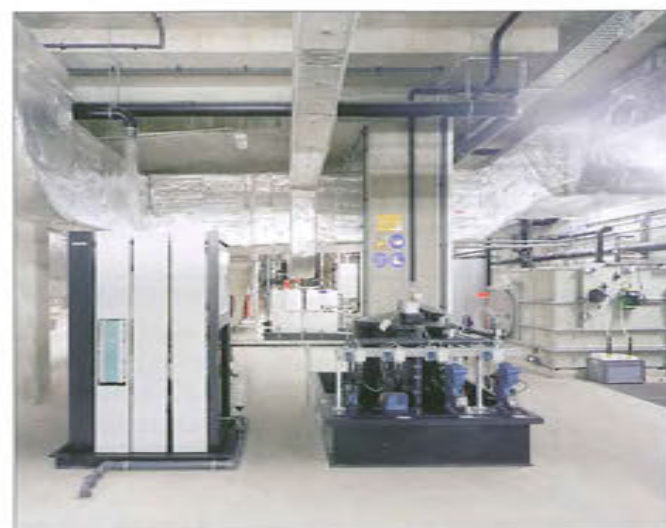
■ Die Technik im Untergeschoss
