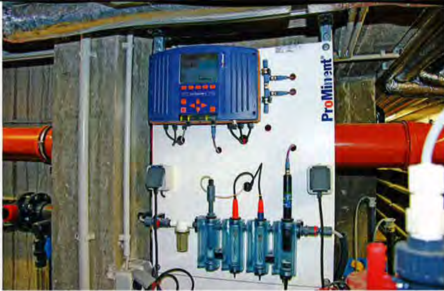
Die gesamte Schwimmbadtechnik ist im Keller versteckt. Hier werden alle wichtigen Parameter für einwandfreie Wasserqualität zentral gesteuert und verwaltet.
