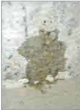
■ Schadensbild: Wasser zwischen alter Beckenwand und neuem Abdichtungssystem
