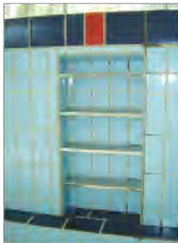
■ Durch den nachträglichen Einbau der Edestahlsprossen wurde die Abdichtungsebene ver- letzt
