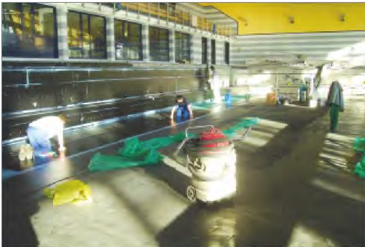
■ Aufbringen der Gummfolie auf der Untergrundspachtelung (Beckenboden) sowie Auftrag der Haft- und Schutzspachtelung (Beckenwände)
