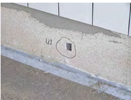
Abb. 7: Reaktionsharzabdichtung in einer gewerblich genutzten Küche inklusive Dichtbandeinlage und Probeentnahmestelle
