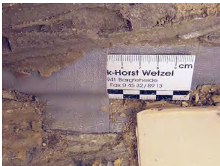
Abb. 25 und 26: Nicht fachgerechter Einbau der Dichtbänder
