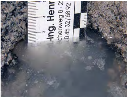
Abb. 3 und 4: Hotelküche mit Nassraumabdichtung aus Bitumenbahnen und dem sich zeitweise auf der Dichtschicht stauenden Abwasser
