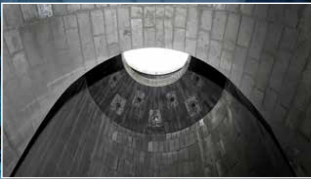
Systemauskleidung mit Kohlenstoffsteinen.
